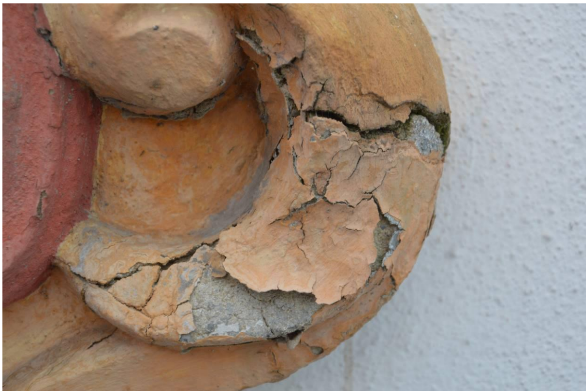
Detail díla – pravá strana - poškození
