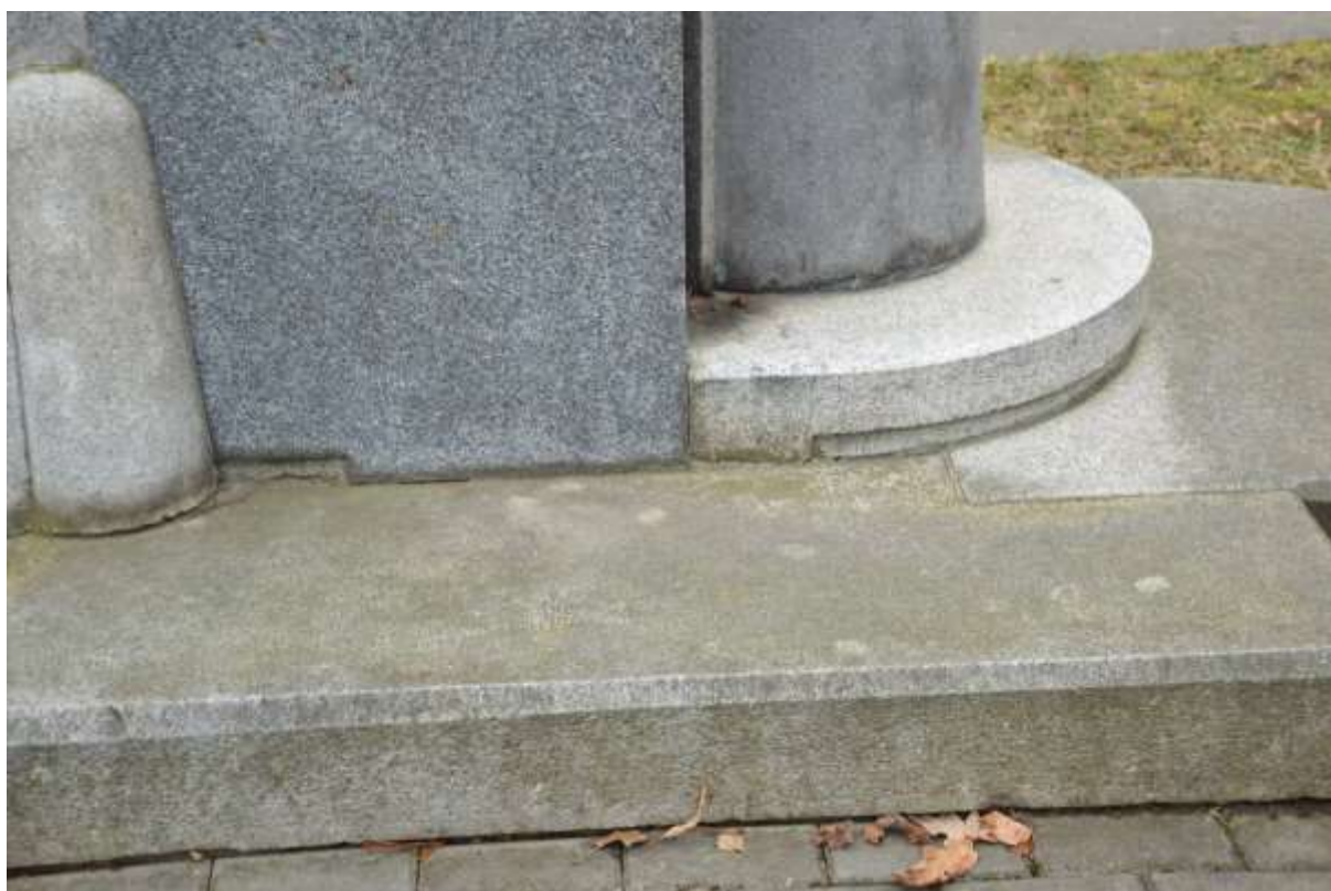
Detaily poškození na mramorovém podstavci
